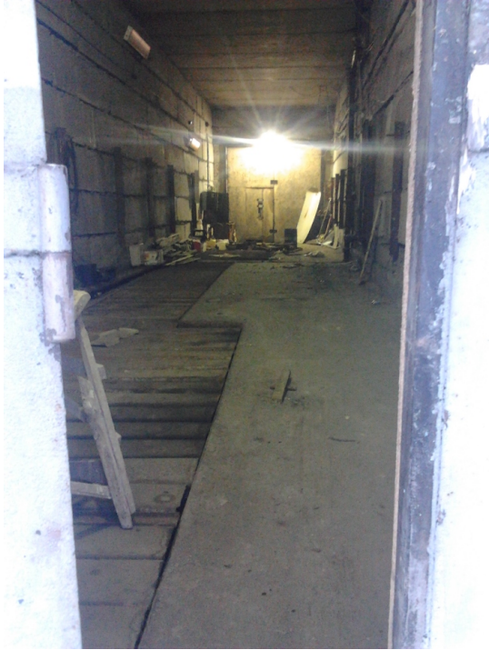
Фото19. Фото от 16.12.2014 года. Срезанные петли на входных в здание дверях. Фото ниже петли брошены под ногами, дверь просто приварена к раме ворот.
